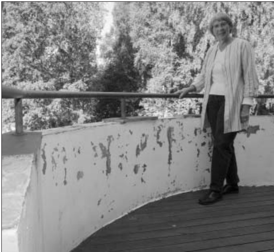
Boligen i Stafsbergveien 24, også kjent som «Kvitmyra», trenger ny maling, utskifting av panel og ny murpuss. Bygningen er ikke vedlikeholdt utvendig på de 12 årene sønnen min har bodd her, sier Liv Grønnæss.
